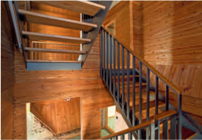
7 Das neue Treppenhaus im Siloschacht mit Brettstapelwänden, aufgenommen vom Podest im zweiten Obergeschoss mit Blickrichtung nach Norden.
