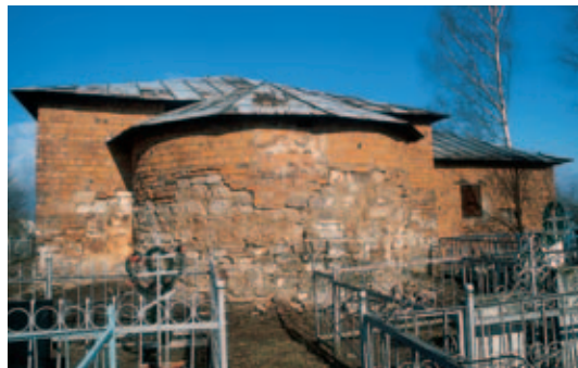
4 Die kriegszerstörte Ruine der Mariä-Entschlafens-Kirche mit Notdach, Zustand April 2001.
