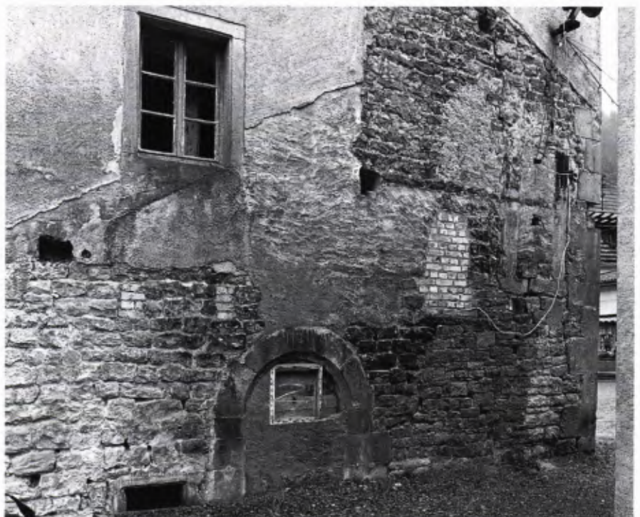
■ 5 Detail der statisch schwer geschädigten Ostansicht mit den Spuren früherer Anbauten und den beiden zugemauerten Ausgängen im Erd- und Obergeschoß (1992).
