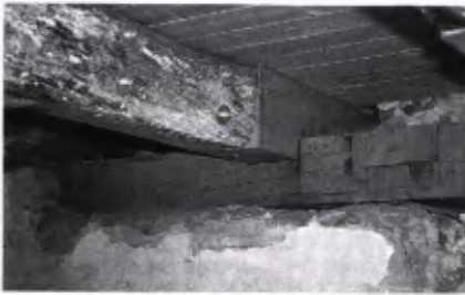
■ 16 Ein Beispiel für die zahlreichen, handwerklich sorgfältig reparierten Balken, hier aus einem Auflagerbereich im 2. Obergeschoß.
