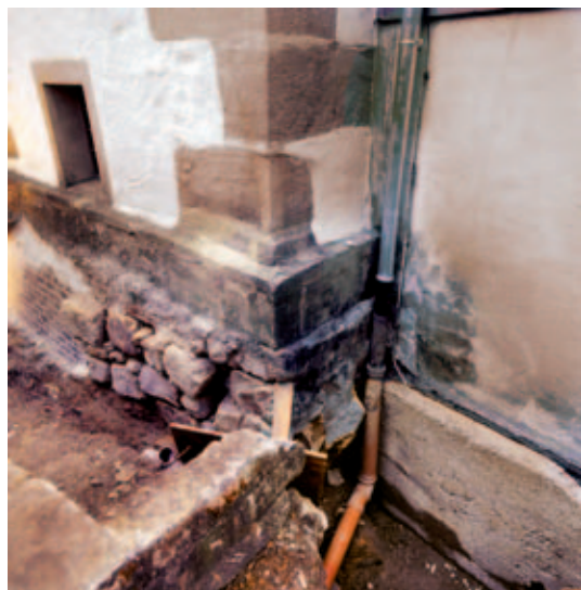
17 Nordwestlicher Bereich des Turmes. Die Fundamentecke ist abgerissen und muss, ähnlich der Reparatur in der Mitte der Turm-nordwand sichtbar, unterfangen und ausgebessert werden. An der Nordwand der Kirche, d. h. der Erweiterung von 1963/64 ist der Graben für die neue Drainage ausgehoben.
