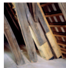
19 Schadensbild der Konstruktion von 1475/76 auf der Nordseite, von Nordwesten. Die Mauerlatten wurden nach der Kirchen-erweiterung von 1963/64 entfernt, die alte Konstruktion mit beigelaschten Hölzern gesichert.
