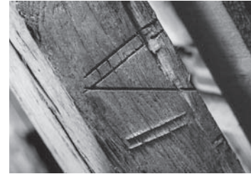
9 Abbundzeichen der Konstruktion von 1475/76. Vollgebinde mit eingestemmt quadratischen Kerben (oben), Leergebinde mit eingeritzten römischen Ziffern (unten).
