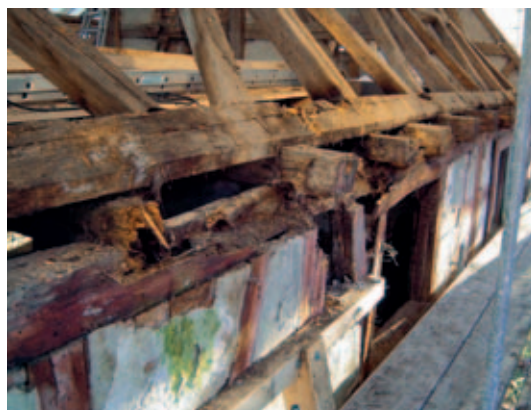
10 Jahrelanger Wassereintritt hat starke Fäulnis-schäden an der Stuhlschwelle, den Balkenköpfen und dem Rähm der südlichen Traufe hinterlassen, Zustand November 2003.
