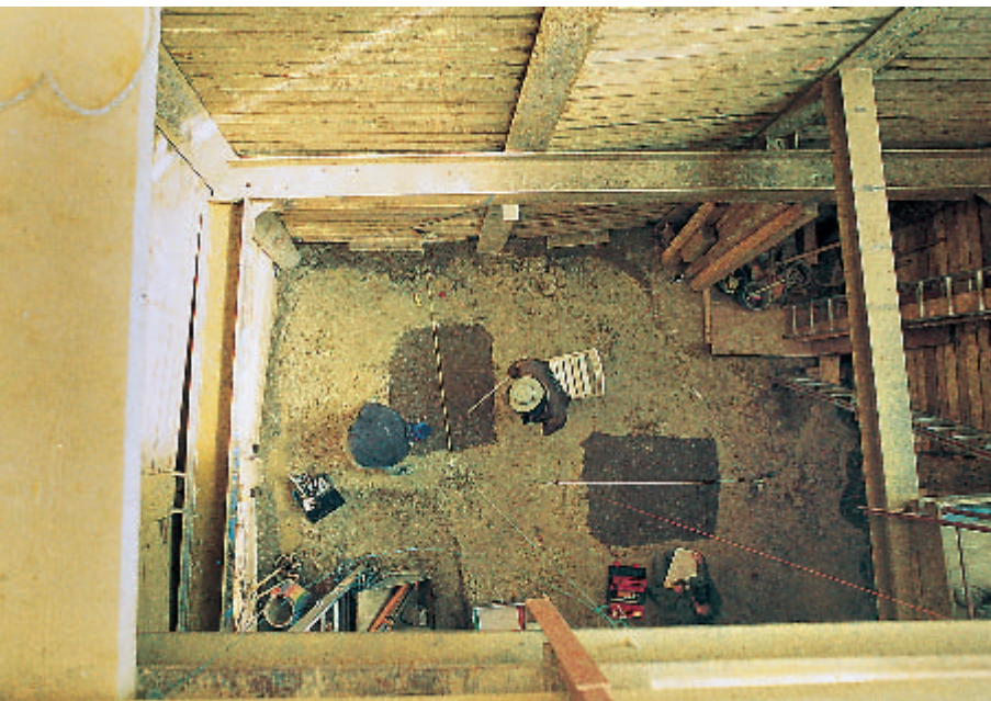
3 Die Brunnenschächte durchstoßen etwa 10 m mächtige Kies- und Sandablagerungen der Risseiszeit, bevor sie auf die Schichten der Molasse treffen. Die Brunnensohlen liegen noch gut 4 m tiefer in festem Felsgrund.
