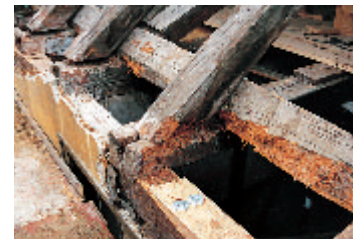
11 Westliche Traufe während der Reparatur: schadhafte Mauerlatte ist bereits ausgetauscht; Vorholz der Zapflöcher ausgebrochen; Fäulnis-schäden an Balkenkopf und Stuhlschwelle, Zapfverbindungen haben sich gelöst. Zustand 1999.
