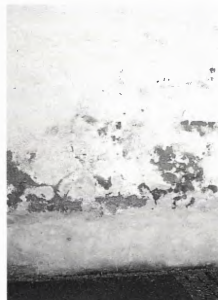
■ 25 Durch aufsteigende Feuchtigkeit verursachte Putzschäden über einem dichten Zementputz.
