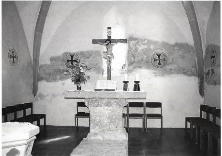
■ 1 Schädigung der historischen Bemalung und Putze durch aufsteigende Feuchtigkeit und Salze, die zum Teil aus den neueren Putzen stammen.
