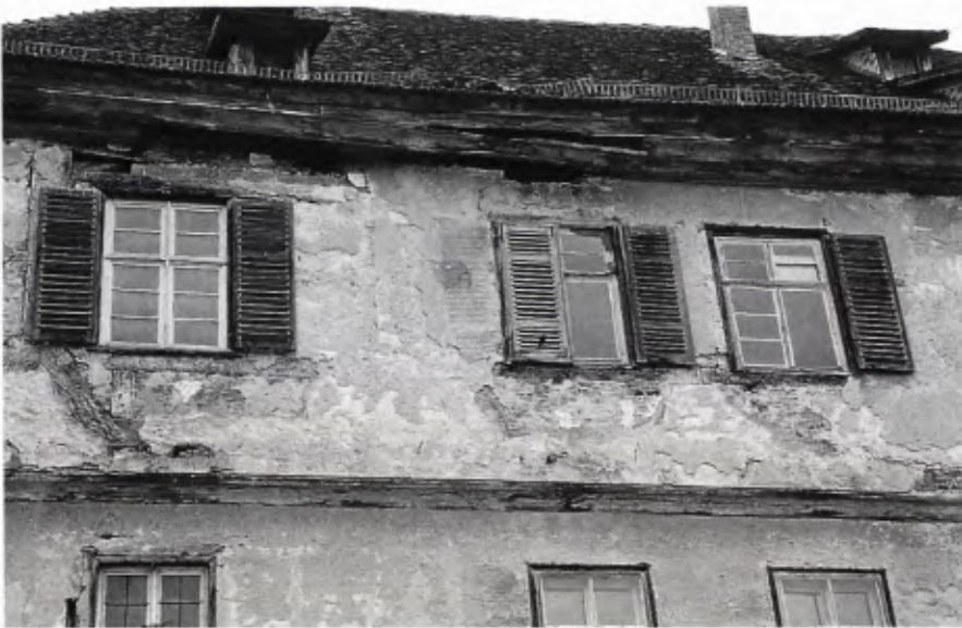
■ 6 Die ausgeprägten Schäden an Außenputz und hölzerner Traufe wurden durch ein undichtes Dach verursacht.
