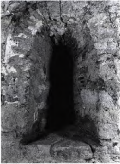
■ 7 Westfenster der Langhaus südwestwand mit Resten der Originalfasche.
