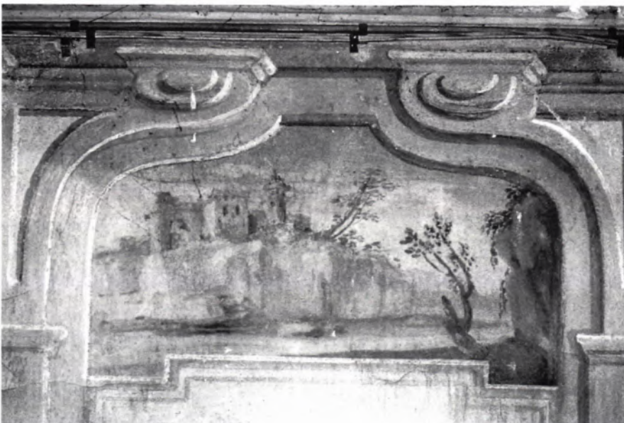
■ 29 Ludwigsburg, Schloß Harteneck, Detail der Wandfresken aus der 2. Hälfte des 18. Jhs., Zustand 1990.
