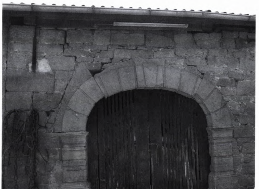
■ 16 Barockportal, Schadensbild. Foto 1996, LDA.
