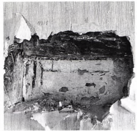
■ 8 Unter den Tapeten war die Vorgeschichte des Alten Pfarrhauses verborgen. Eine mit schwarzen Kontur- und Begleitstrichen auf einfache Weise hergestellte Gestaltung des Fachwerkes.
