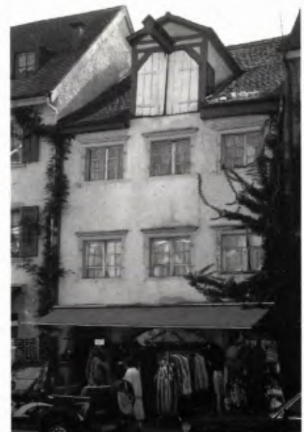
■ 6 Meersburg; wie können wir die wenigen historischen Fenster noch retten?
