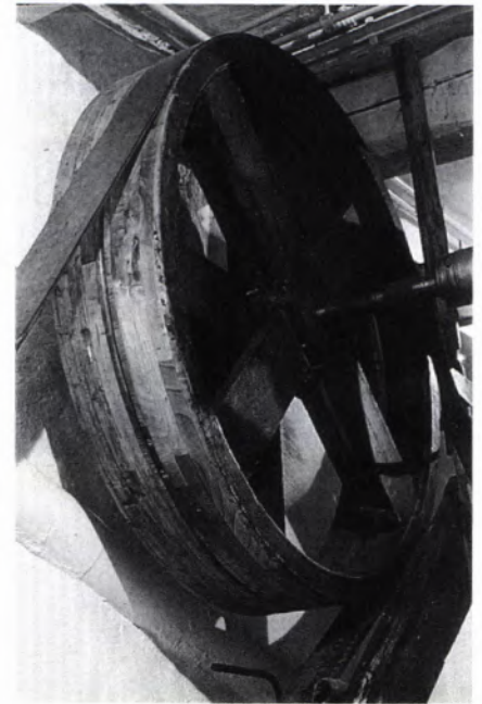
■ 4 Hauptantrieb mit Treibscheibe und Leerlaufscheibe. Am rechten Bildrand ist der improvisierte Riemenschutz erkennbar. Zustand nach Reinigung und Konservierung.
