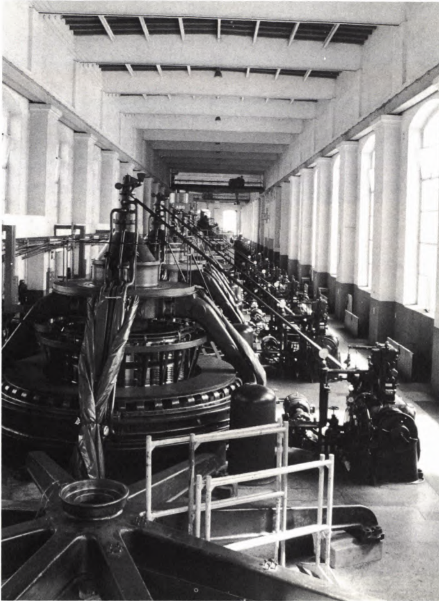
■ 10 Blick in die Maschinenhalle, heute; im Vordergrund die noch vorhandenen Gleichstromgeneratoren.
