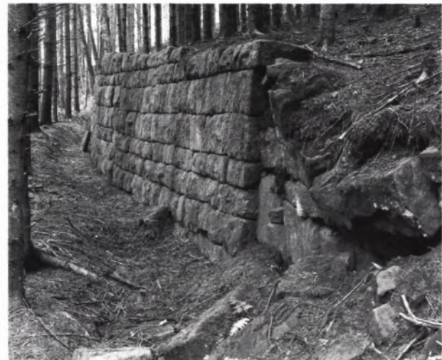
4 MITTLERER GRABEN mit hangseitiger, erneuerter Stützmauer, z.T. verstürzt. Der ehem. Wasserlauf tritt durch den talseitig dammartig ausgebildeten Rand deutlich hervor.
