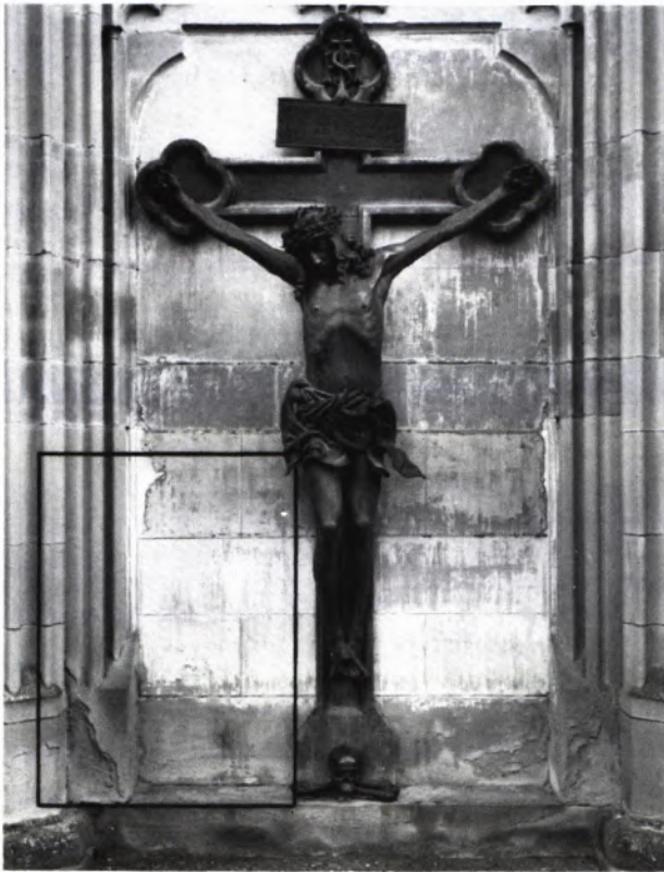
8 SALEM, ehem. Klosterkirche, nördliches Querhaus. Aufnahme von 1935. Die Sockelpartie bis zur dritten Steinlage sowie die unteren Gewändesteine sind Auswechslungen (vgl. dazu auch U. Knapp, 1988, dortige Abb. 1). In den unteren Bereichen hatten sich bereits damals neue Steinschäden entwickelt.
