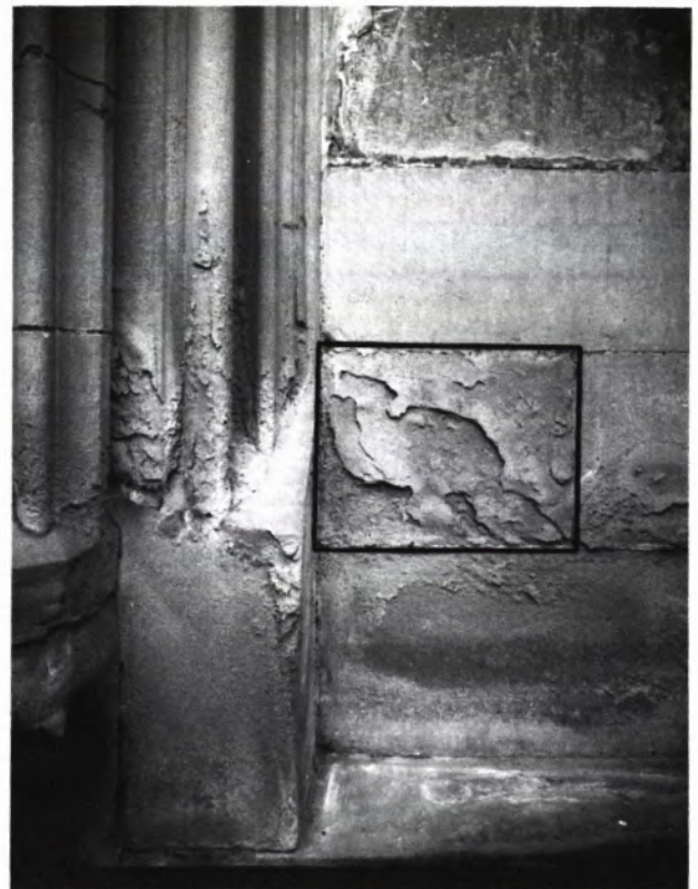
9 SALEM, ehem. Klosterkirche, nördliches Querhaus. Photogrammetrische Nahaufnahme von 1988 zur Schadensvermessung. Am linken Sockel ist die Oberfläche des Steines vollständig abgetragen, der Schaden hat auf die Profile der Gewände übergriffen. Der untere zurückliegende Stein im Bogenfeld ist ebenfalls stark abgewittert. Die beiden darüberliegenden Steine waren 1935 noch intakt gewesen und zeigen nun starke Schalenbildungen. Die Schäden sind auf Feuchtebeeinflussungen, Salzausblühungen und damit verbundene Absprengungen im Molassesandstein zurückzuführen.
