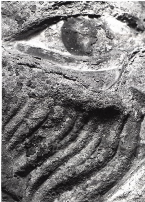
9 „HÖLLENRACHEN“, Detail aus dem Tympanon des nördlichen Chorportals: in Schollen aufstehende und vom Abplatzen bedrohte Malschicht.
