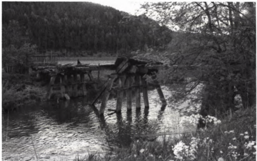
1 HORB-NECKARHAUSEN, die Pfahljochbrücke im Jahr 1985. Pfähle, Bohlenbelag und Geländer sind von Holzschädlingen befallen und vermorscht.
