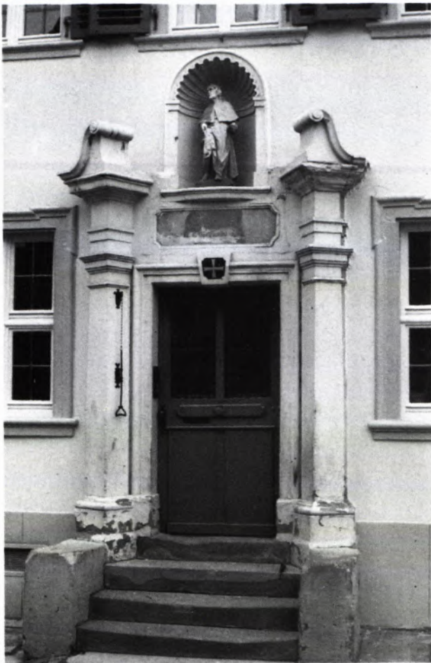
6 LADENBURG, Kirchenstr. 7, 1770. Rochusportal am ehem. Güntherschen Waisenhaus. Häufung der unterschiedlichsten Sandsteinschäden: mit Zement ausgeflickte Stufen, Salzsäure an den Säulenbasen, diffusionshemmender Dispersionsanstrich, Absanden der Inschrift, Verwitterungsspuren am rechten Sprenggiebelgesims. Die Rochusfigur mit irreparablen Substanzverlusten (Arm, Gewand) aufgrund von chemischen Umwelteinflüssen muß abgenommen werden.
