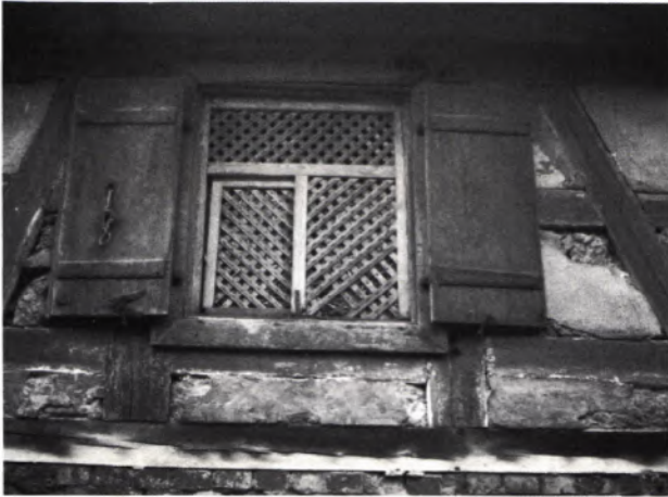
5 HÖLZERNE GITTERFENSTER mit Schiebeteil an einem Scheunengebäude aus der Barockzeit in Sulzdorf, Stadt Schwäbisch Hall.
