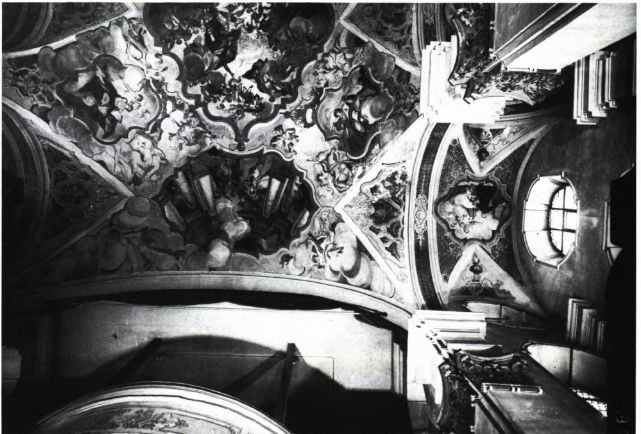
10 PHOTOGRAMMETRISCHE SENKRECHTAUFNAHME für die Vermessung der Deckenansicht im Schiff. Die Orgelempore ist mit zwei Hängebalken in den darüberliegenden Dachstuhl eingehängt. Am Übergang zur Flachdecke, Achse 2, ist die 1927 eingezogene Horizontalschlauder sichtbar.
