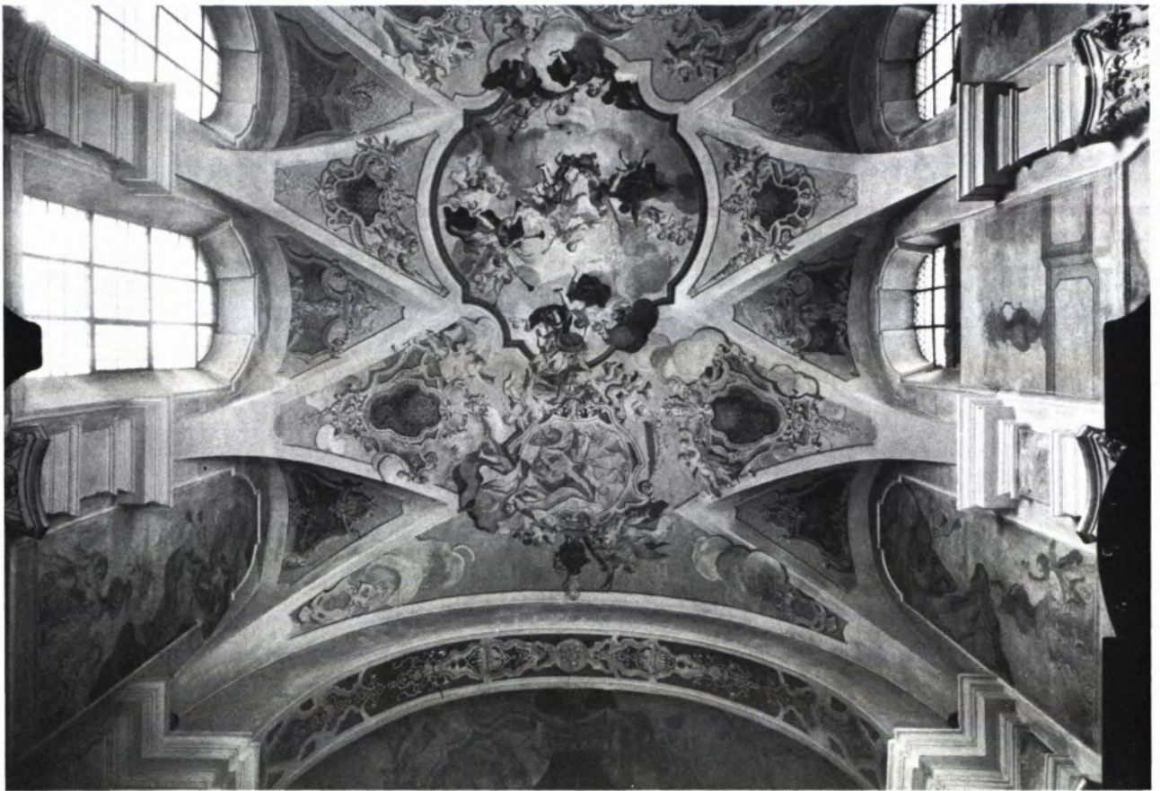
9 PHOTOGRAMMETRISCHE SENKRECHTAUFNAHME für die Vermessung des Gewölbes im Chor. Im Scheitel des Chorboogens befindet sich ein 3 mm starker Riß.
