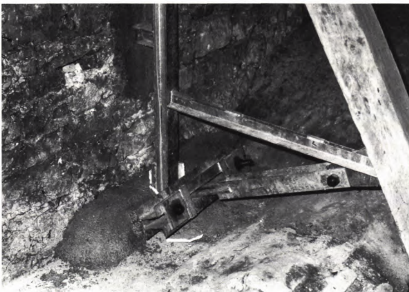
22 VERANKERUNG des Zugbinders über den Gewölbebogen. Über die beiden Schrauben am Gewölbeanfang wurde der Stahlbinder in zeitlich versetzten Etappen vorgespannt.
