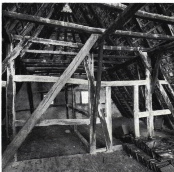
8 BLICK IN DEN DACHRAUM (vor der Instandsetzung). Über dem Krüppelwalm befindet sich das vermauerte Rauchloch.
