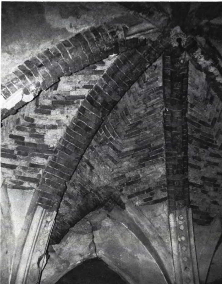
12 SCHADHAFTES GEWÖLBE im Bergfried.
