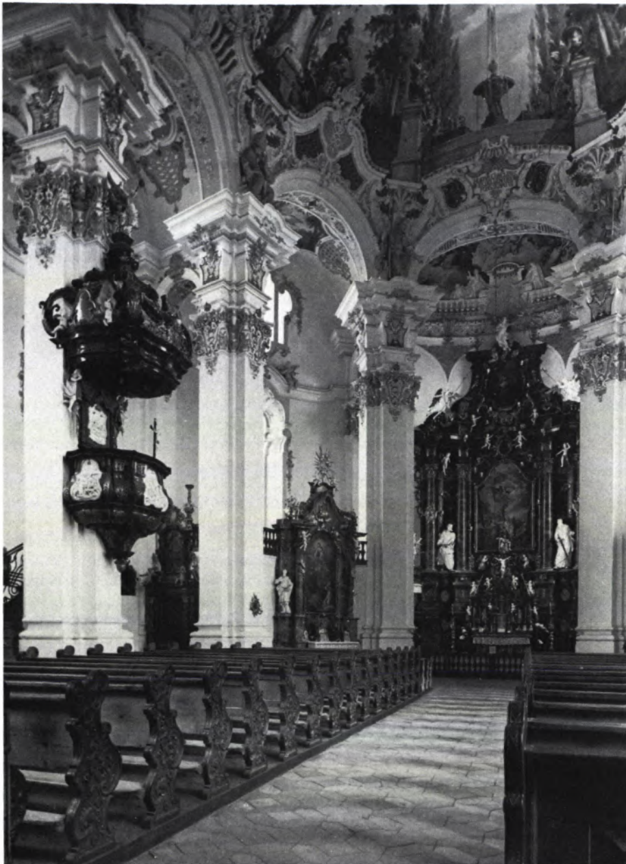
1 STEINHAUSEN, Wallfahrtskirche: Der Blick in den Innenraum zeigt die Pfeilerstellung, den Umgang und die Hauptkuppel, die durch statische Schäden stark gefährdet war.
