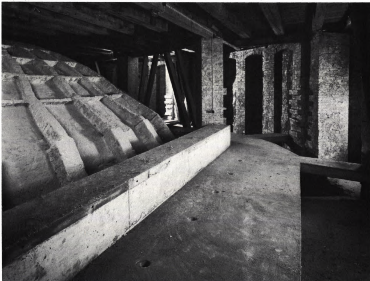
4 ZUSTAND NACH FERTIGSTELLUNG DES RINGANKERS. Auf seiner Oberseite erkennt man die Lüftungslöcher. Links die Hauptkuppel; in der Bildachse hinten wieder einer der alten Mauerpfeiler; rechts die Übermauerung der Kirchenaußenwand.
