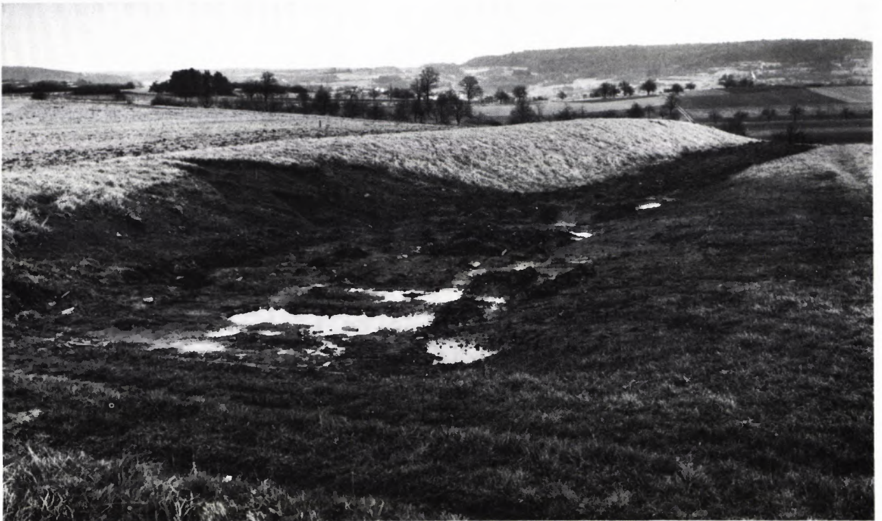
3 EHEMALIGER LANDGRABEN: ZUSTAND AM 12. JANUAR 1976. Der Pächter hat den Bauaushub im Graben verteilt und dabei den Wall beschädigt.
