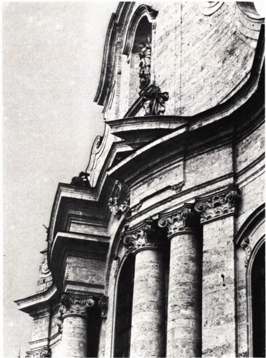
5 AUSSCHNITT AUS DER HAUPT- FASSADE: Zustand nach der Frei- legung des Mauerwerks und der Ver- fugung im Jahre 1906/07 (Aufnahme von 1928).
