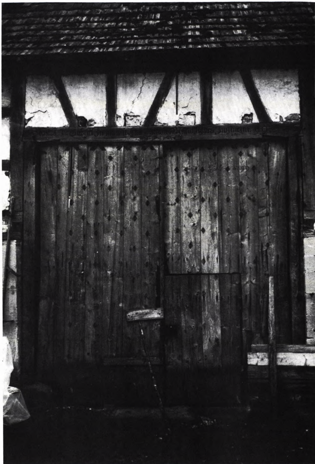
3 AMMERBUCH-BREITENHOLZ. BEI DER LINDE 21. Das ganzflächig bemalte Scheunentor mit Inschriftbalken aus dem Jahr 1799.
