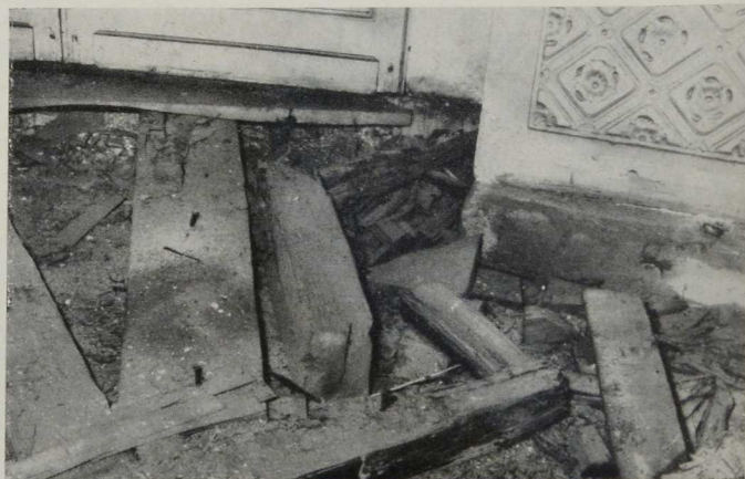
Schloß Solitude. Schäden im Bodengebälk des weißen Saales
