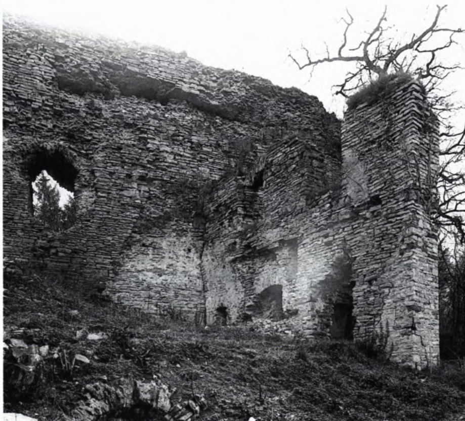
10 ZUZENHAUSEN, Innen- seite der Schildmauer mit ange- bauer Gebäudewand. An meh- reren Stellen ist die Mauerschale ausgebrochen. Die Ruine ist nicht nur in ihrer Substanz be- droht, sie ist auch durch sich los- lösende Steine gefährlich für Be- sucher und spielende Kinder.
