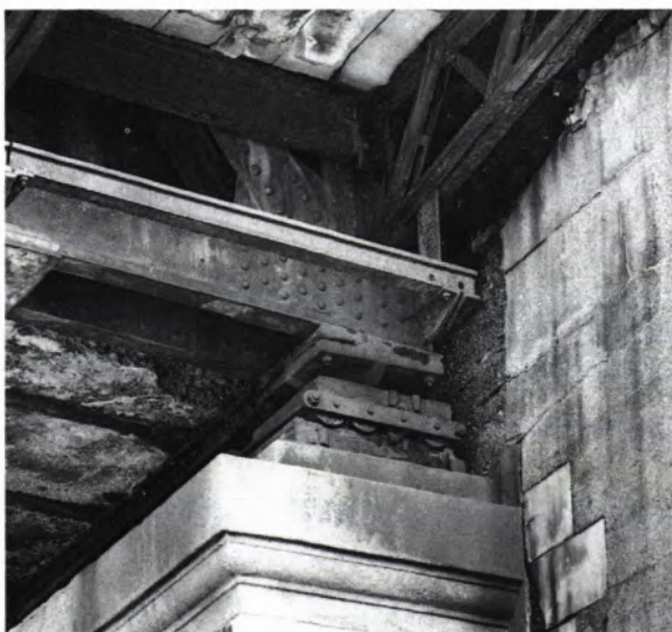
4 AUFLAGER am Brückenkopf (1985). Es sind erhebliche, durch Streusalz verursachte Rostschäden zu erkennen.
