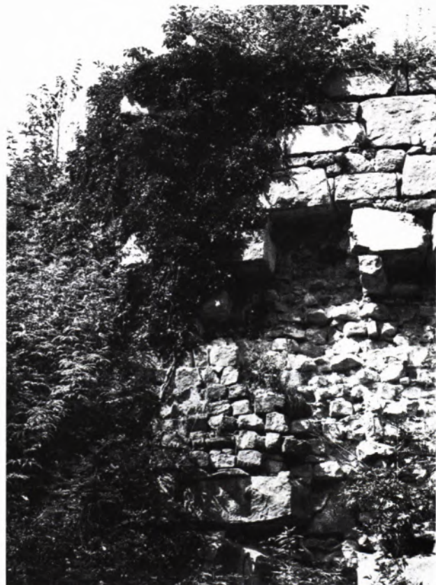
2 SCHÄDEN durch Witterung, Kletterer und Abbruch von Quadern zum Häuserbau.
