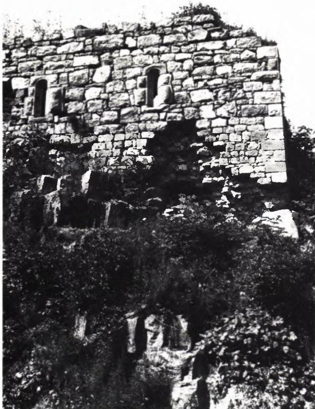
4 PALAS-NORDWAND. Die abgestürzte Schale des Vorsatzmauerwerks gab den Anstoß zur Sanierung.
