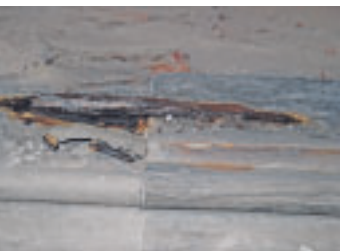
5 Verformter und abgerissener Säulenfuß. Zustand 2012.
