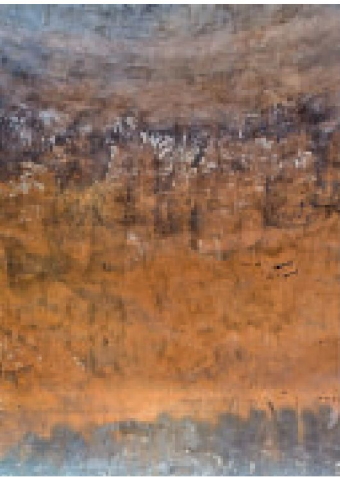
10 Kein Kunstwerk! Rostspuren und Kalkablagerungen überziehen auch heute noch die Innenwände des Wassertanks.
