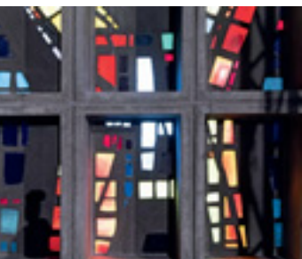
8 Farbverglaste Betonkassette in der ehemaligen Trinitatiskirche Mannheim von Helmut Striffler.
