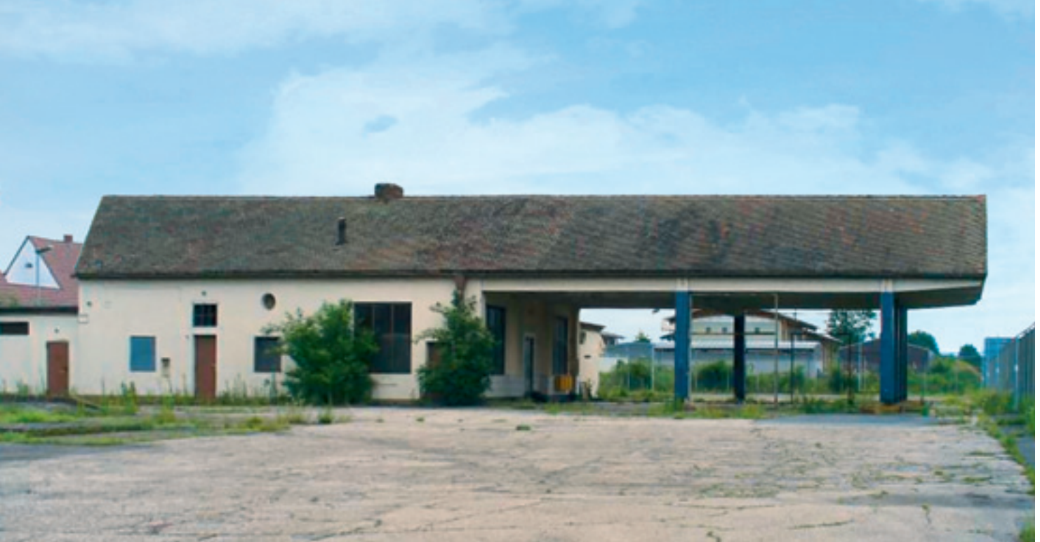
5 Heutiger Zustand der ehemaligen Reichsautobahntankstelle Mannheim-Seckenheim von Paul Schmitthenner, Nutzung als Werkhof für die Autobahnmeisterei, 2011.
