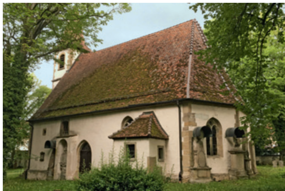
3 Zustand der Gottesackerkapelle vor der Restaurierungsmaßnahme.
