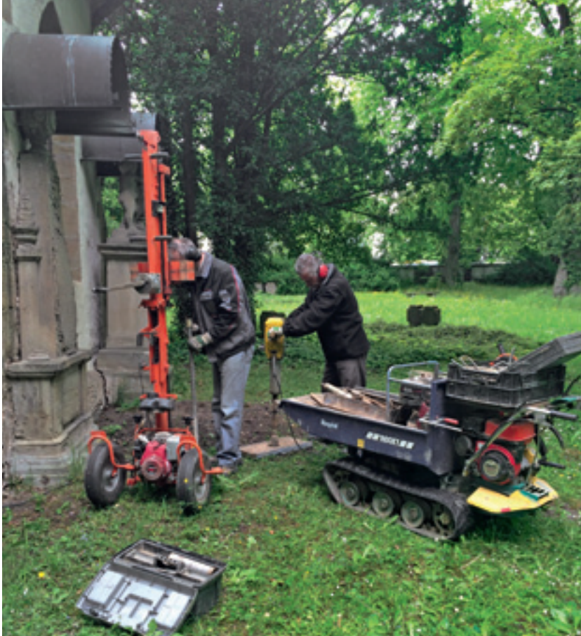
4 Im Vorfeld wurden mehrere Untersuchungen durchgeführt. Wegen der Rissbildung wurde auch der Baugrund untersucht.
