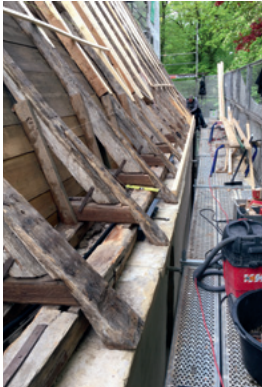
6 An der Nordseite wurden mehrere Dachsparren instandgesetzt, die starke Verformungen aufwiesen. Ein Sparren war bereits gebrochen.
