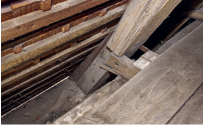
10 Stark verschobene, nicht kraftschlüssige Blattverbinding.
