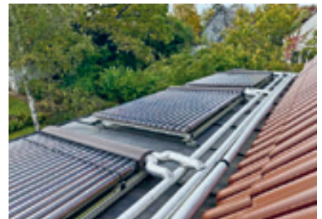
6 Solarthermie auf dem angeschleppten Süddach eines Wohnhauses.
