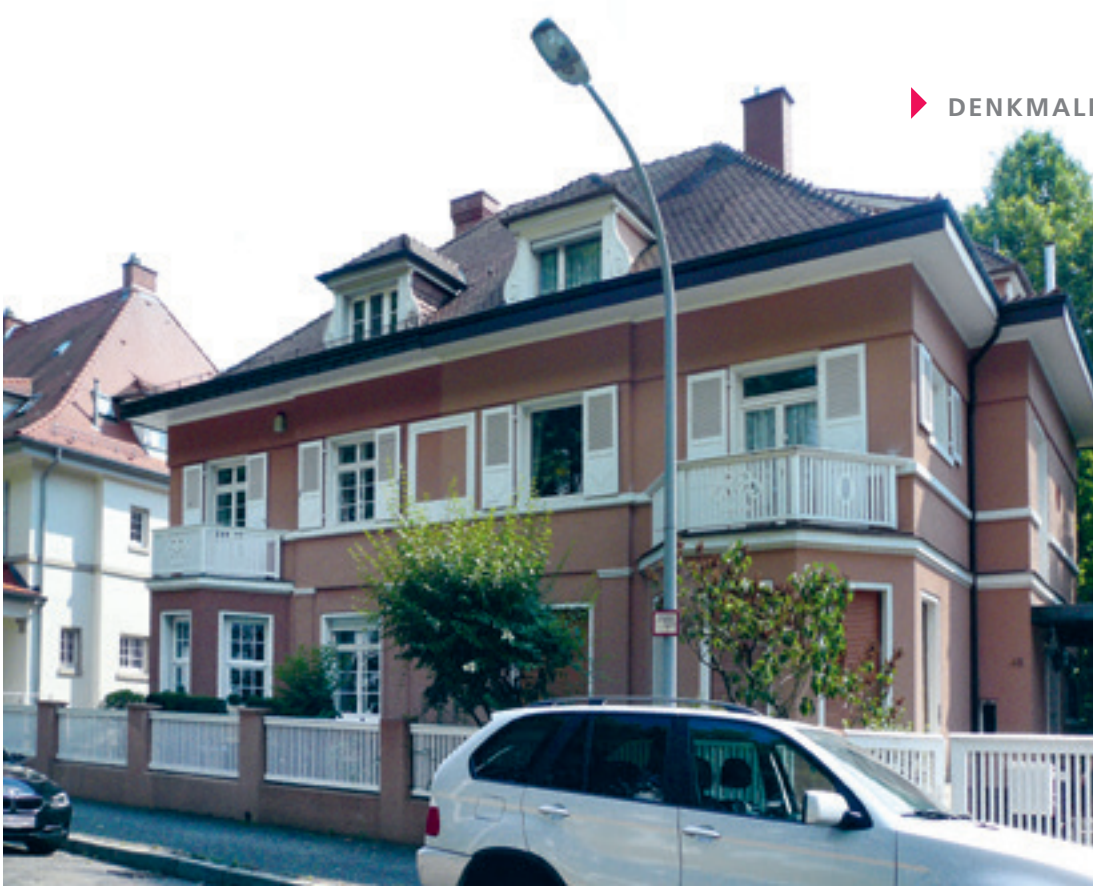
5 Mannheim, Paul-Martin-Ufer, Doppelwohnhaus mit Rollläden im Erd- und Klappläden im Obergeschoss, beides aus der Erbauungszeit. Die Rollläden verschwinden, wenn sie hochgezogen sind, vollständig in den Rollladenkästen.
