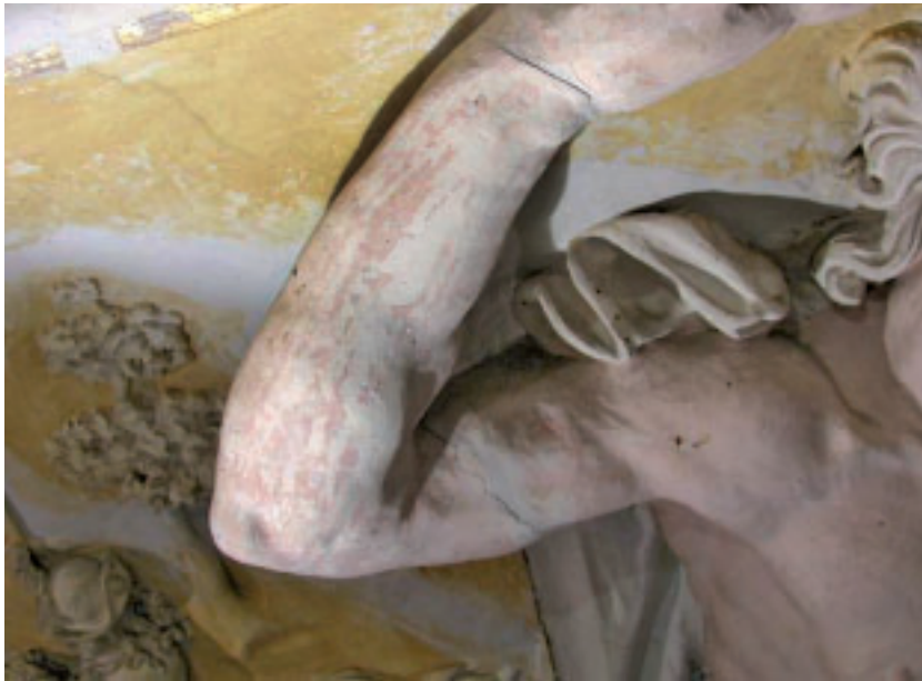
2 Atlant, Stuckfigur auf der Ostseite mit gravierenden Stauchungen, ausgehend von den Schäden am Dachwerk.
