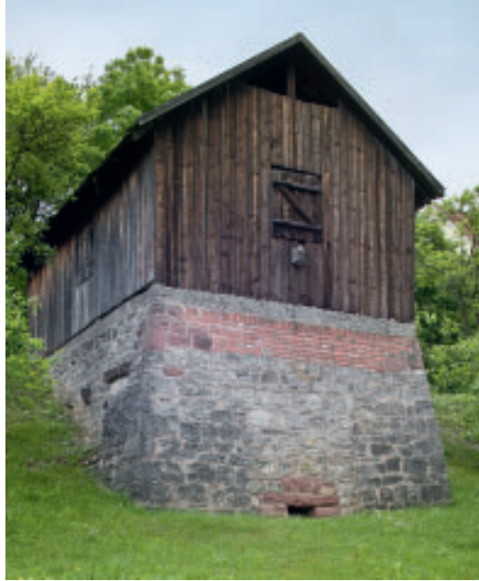
4 Eine sanierte Darre mit Steinsockel und Schürloch. Der Aufbau als Fachwerk mit verputzten Traufwänden.
