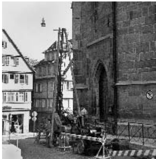
5 Verfüllung und Verpressung des ehemaligen Luftschutzstollens mit Beton vor der Westseite der Stiftskirche, Aufnahme 1965.
