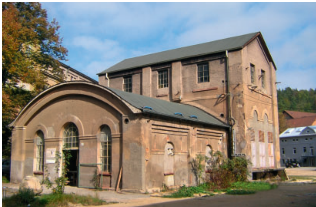
1 Rottweil, Neckartal 207, Rottweiler Pulverfabrik, ehemaliges Pumpenhaus. Ansicht von Südwest vor der Sanierung.
