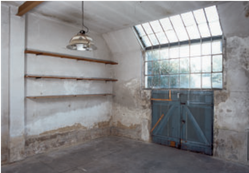
6 Das große Atelier mit dem eisernen Unterzug für das Hebewerk, großem Fenster und hoch ansetzenden Regalen.
