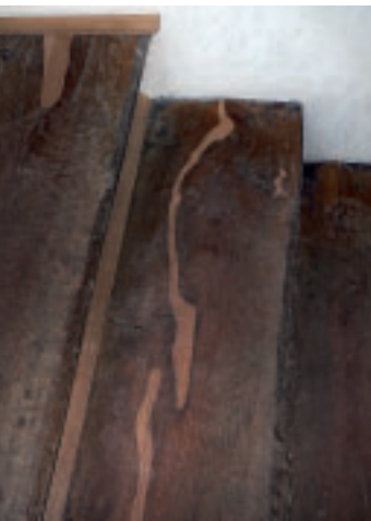
6 Treppe mit den deutlich erkennbaren Reparatureinsätzen.
