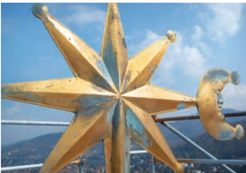
4 Freiburg Münster. Korrodierte Wetterfahne vor der Restaurierung.
