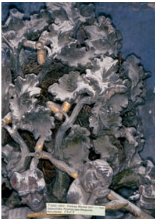
1 Freiburg Münster. Turmhalle, Tympanon: Detail der Judasszene mit Staub, Vogelkot und Schmutzkruste.
