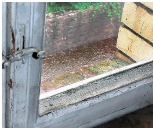
9 Schramberg, Ham- burg-Amerikanische- Uhrenfabrik (HAU), Gebäude 3/5. Scheiben- zwischenraum eines pan- zerverglasteten Fensters. Nach einigen Jahrzehnten entsteht ein unansehn- licher Scheibenzwischen- raum durch Kondensat, Auflösung der Farbe und Staubablagerungen.
