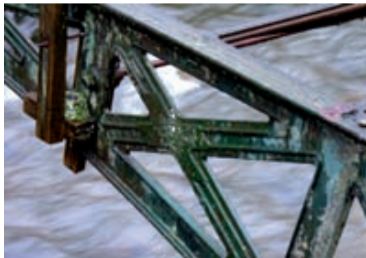
6 Detail der Konstruktion der Schiltachbrücke mit den gegossenen Auflagern für die frei eingelegten Gusstrittplatten.
