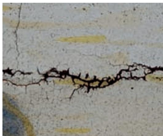
7 Risse mit starken Verschmutzungen.
