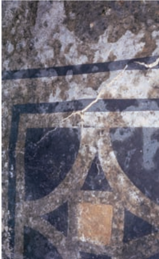
8 Schäden durch Wasserinfiltration, Mittelschiff, Nordostecke.
