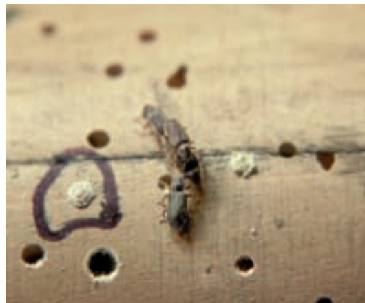
1 Bohrmehlhäufchen mit Krater und Schleifspuren auf einem Dielenboden.
