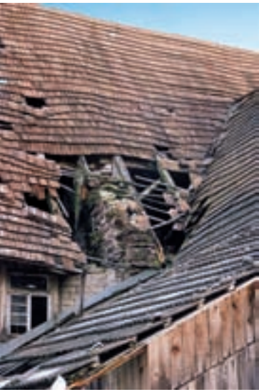
Dachschaden beim Scheunenqueranbau
